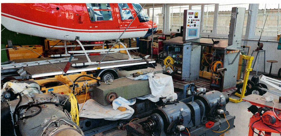
Neben dem Jet Ranger HB-XLA befindet sich der zerlegte Prüfstand für die Turbomeca Artouste-Turbinen. Roland Triet will ihn wieder in Betrieb nehmen.
